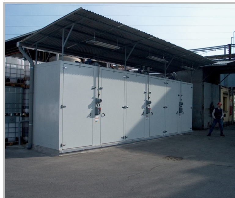
Horizontal varmeovn til 48 tromler, opdelt i 3 individuelle rum, hver til 16 tromler. Temperatur op til 150°C, drevet af varm olie. ATEX godkendt og uden dørs installeret.
